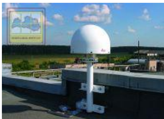
22.attēls. Bāzes stacijas antena uz ēkas jumta
